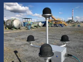
Sistema AGLED (Acoustic Gas Leak Early Detection), que alia sensores acústicos (microfones) e inteligência artificial (IA).
